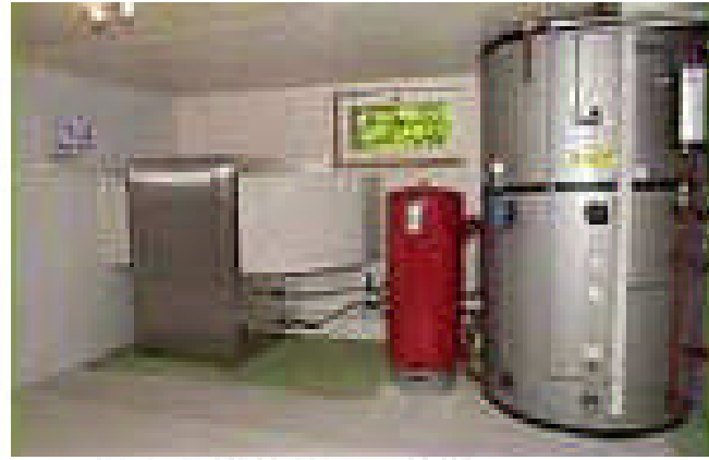
PAC Air/Eau int. Collectif
